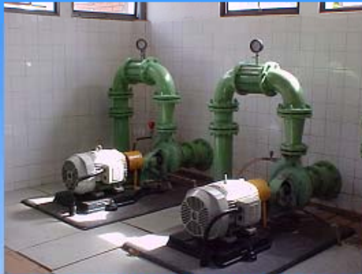
Estação elevatória de água tratada da cidade de Lins
