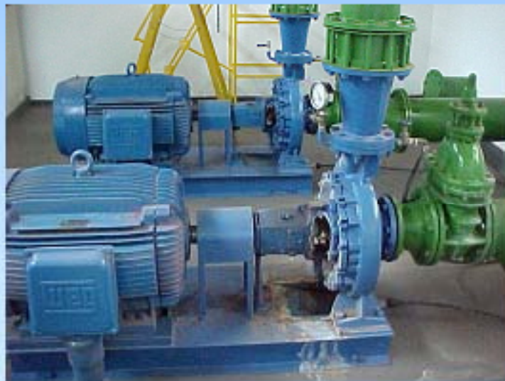
Estação elevatória da cidade de Fernandópolis
