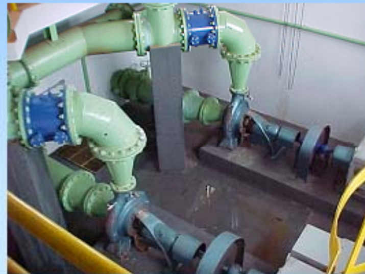
Estação elevatória do poço I da cidade de Jales
