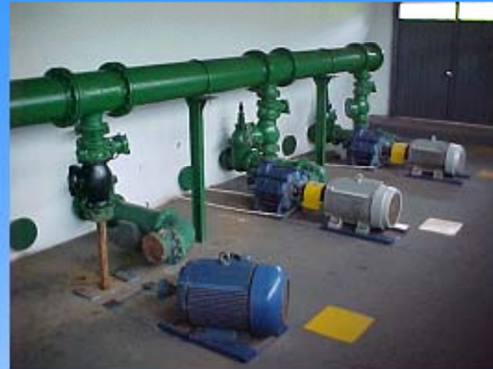
Estação elevatória de recalque dos poços I e III da cidade de Fernandópolis
