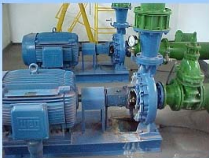
Estação elevatória da cidade de Fernandópolis
